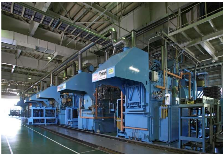
新潟工場 ガス浸炭処理ライン
