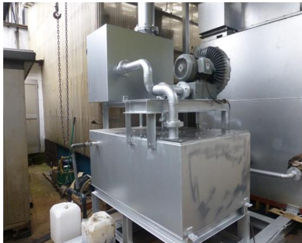
排ガス処理装置
