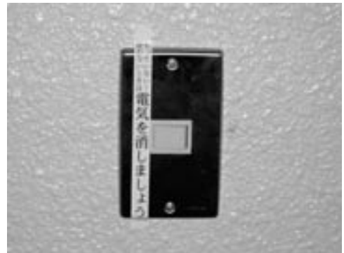
<シールが貼られた電灯のスイッチ>
