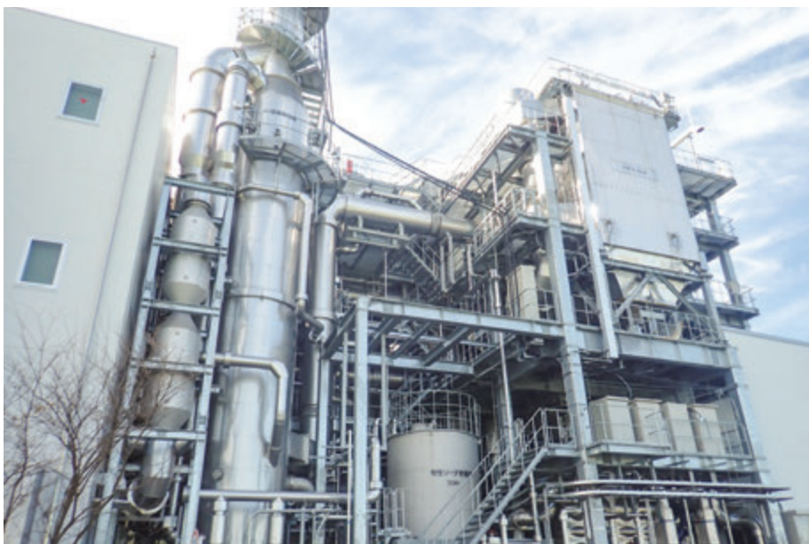
写真 - 1 新2号汚泥焼却炉
