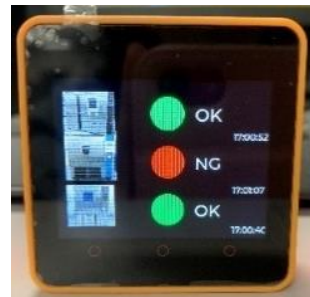
図4 事務室に設置した監視画面
