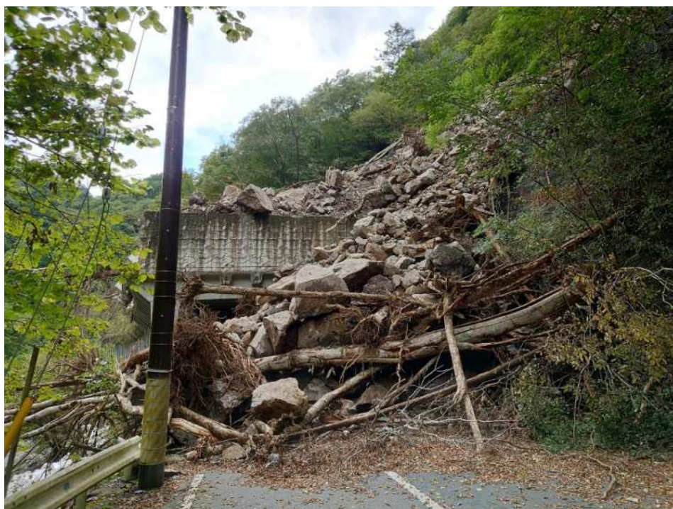
県道中津川三峰口停車場線 被災直後（中津川側）
