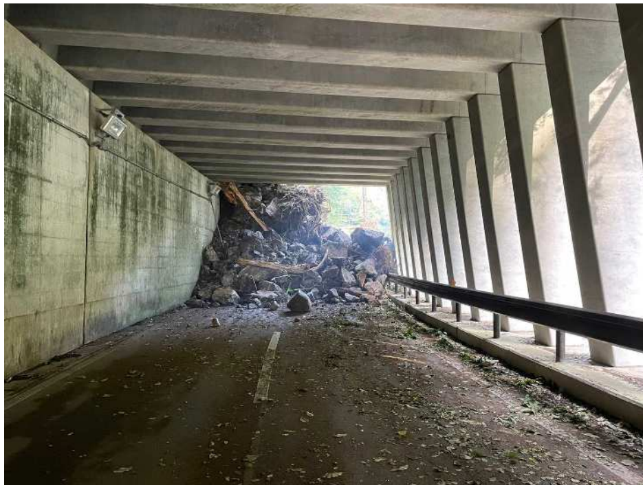
県道中津川三峰口停車場線 被災直後（大滝側）
