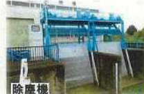
②男沼排水機場
