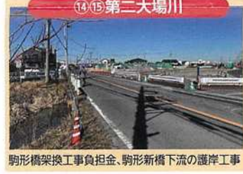
⑭⑮ 第二大場川 駒形橋架換工事負担金、駒形新橋下流の護岸工事
