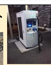
電気自動車用急速充電器
