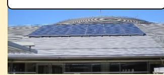
太陽光発電設備
