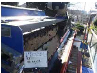
脱水された堆積土
