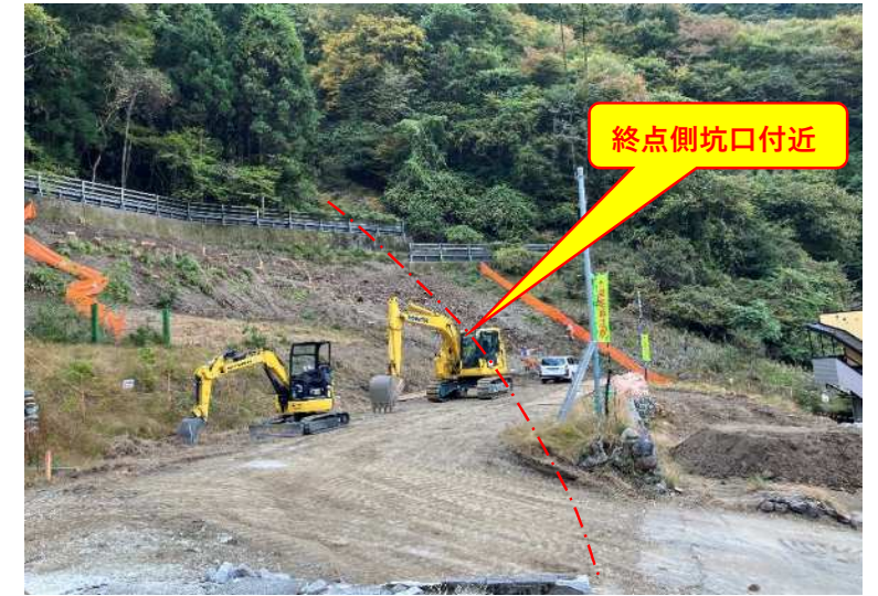
終点側坑口箇所（大滝落合地区側） トンネルが貫通する箇所の掘削準備を始めました。
