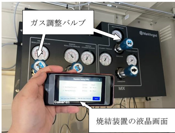
図 12 システム導入後のガスボンベ庫での調整
