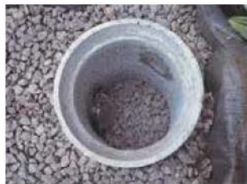
雨水浸透ます
