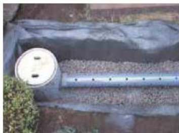
雨水浸透トレンチ
