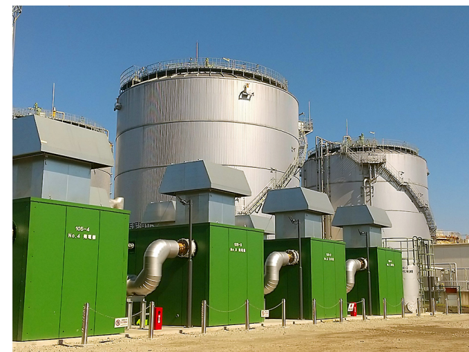
写真1-1 中川水循環センターの消化槽とバイオガス発電機
