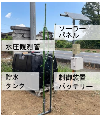
写真1 灌水制御装置
