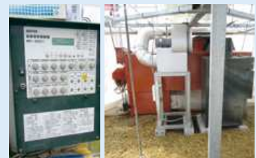
統合環境制御装置及び運動する機器 (Co2 施用システム)
