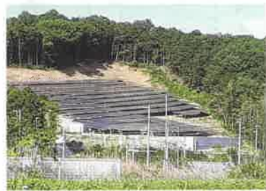
線路のすぐ上、丘陵を削って設置されたソーラーパネル(下部の白く見える塀が線路)
