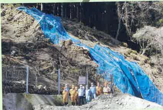
▲施工会社・県職員の方々と開削直前のトンネル坑口にて
