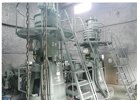
▲揚水機場 揚水ポンプ（権現堂第 2 揚水機場）
