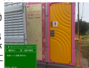
女性専用快適トイレの設置
