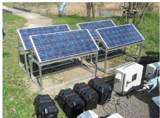
写真4 太陽光発電システム
