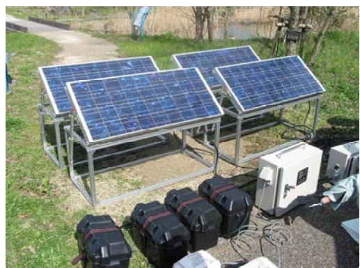
写真4 太陽光発電システム
