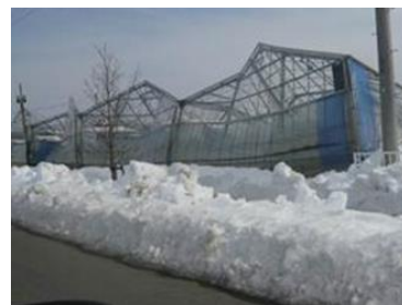
写真 2.2 農業用施設の被害状況
