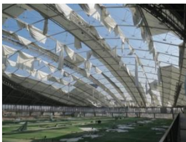
写真 2.1 彩の国くまがやドームの被害状況
