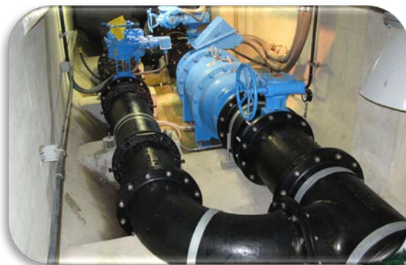
小水力発電設備
