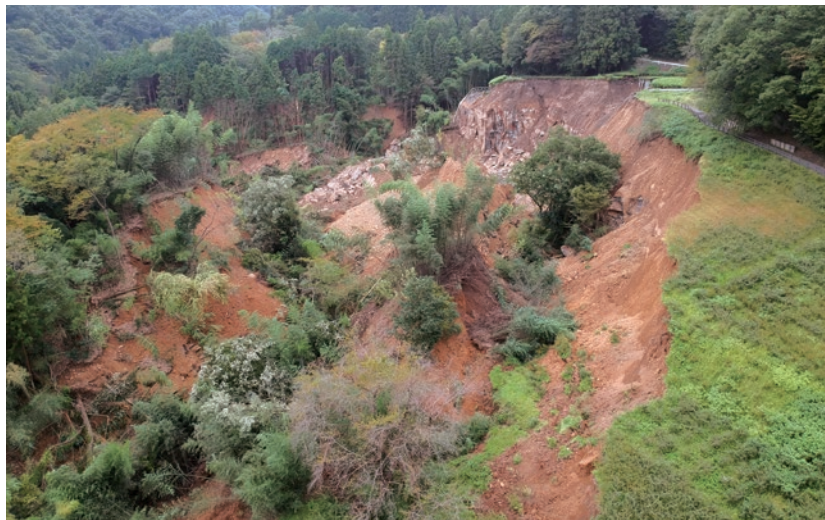
令和元年東日本台風による地滑りの状況(秩父市)
