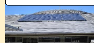
太陽光発電設備
