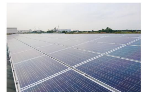
太陽光パネル (中川水循環センター)
