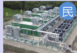
バイオガス発電施設
