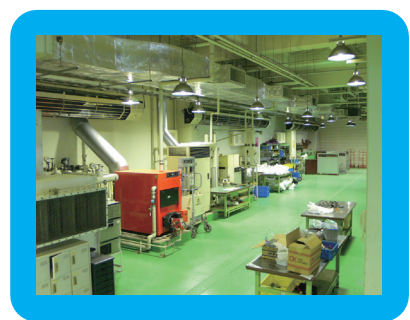
⑦ 実習室(1) 温水ボイラーや温風暖房機などの実習設備
