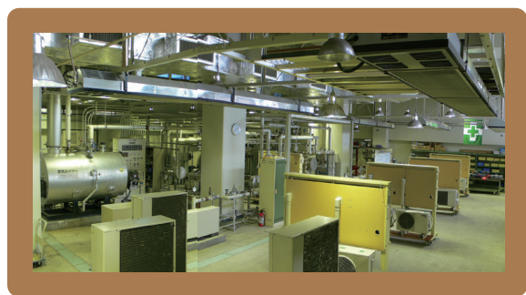
⑧ 実習室 ボイラーの取り扱い運転管理や熱源設備、給排水設備の保守管理などを学ぶための設備類
