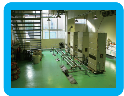
⑧ 実習室(1) 業務用エアコンなどの実習設備
