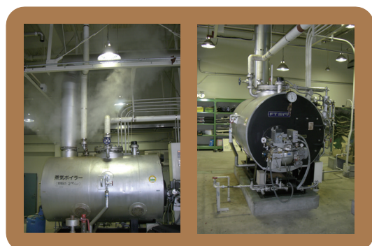
⑨ 炉筒煙管ボイラー
