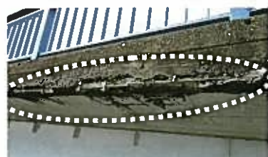
▲橋りょうの床版劣化事例
