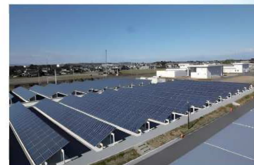
太陽光発電装置を行田・吉見浄水場に設置 (写真は吉見浄水場)
