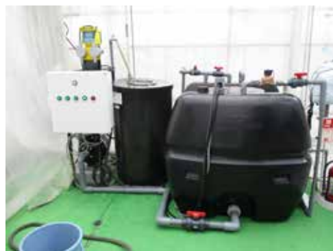
▲いちごハウスに導入した養液栽培装置
