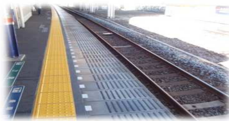
内方線付き点状ブロック
