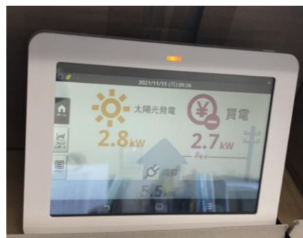
発電モニタ（補助対象設備）
