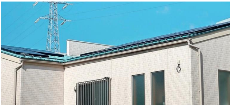
太陽光パネル（補助対象設備）
