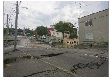
札幌市里塚地区(液状化被害)
