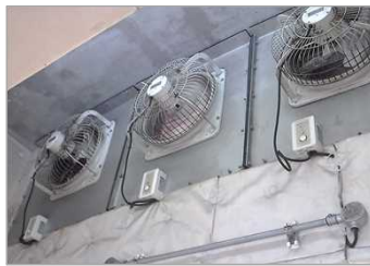
大規模換気設備
