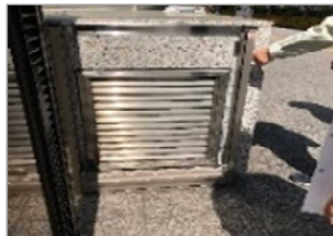
地下街の換気設備口
