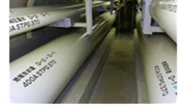
エネルギー導管
