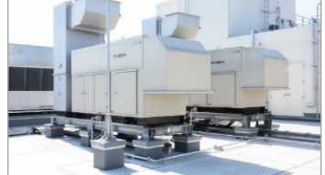
電源設備の高層階設置
