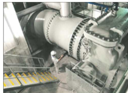
雨水ポンプの整備
