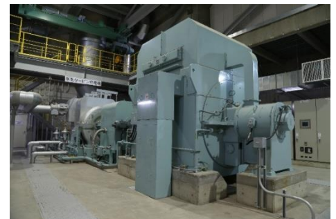
熱回収設備（蒸気タービン発電設備）
