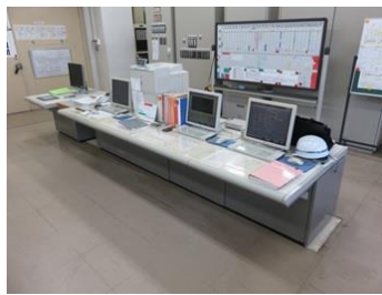
春日部中継ポンプ場 監視制御設備
