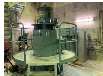
日進中継ポンプ場 ポンプ設備
