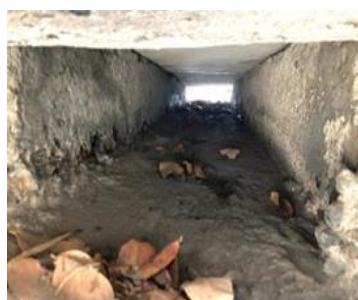
土砂が堆積した下水管
