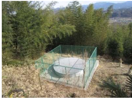
地すべり対策 集水井(桜ヶ谷(皆野町))
