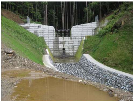
土石流対策 砂防堰堤(滝山・萬開沢(ときがわ町))
