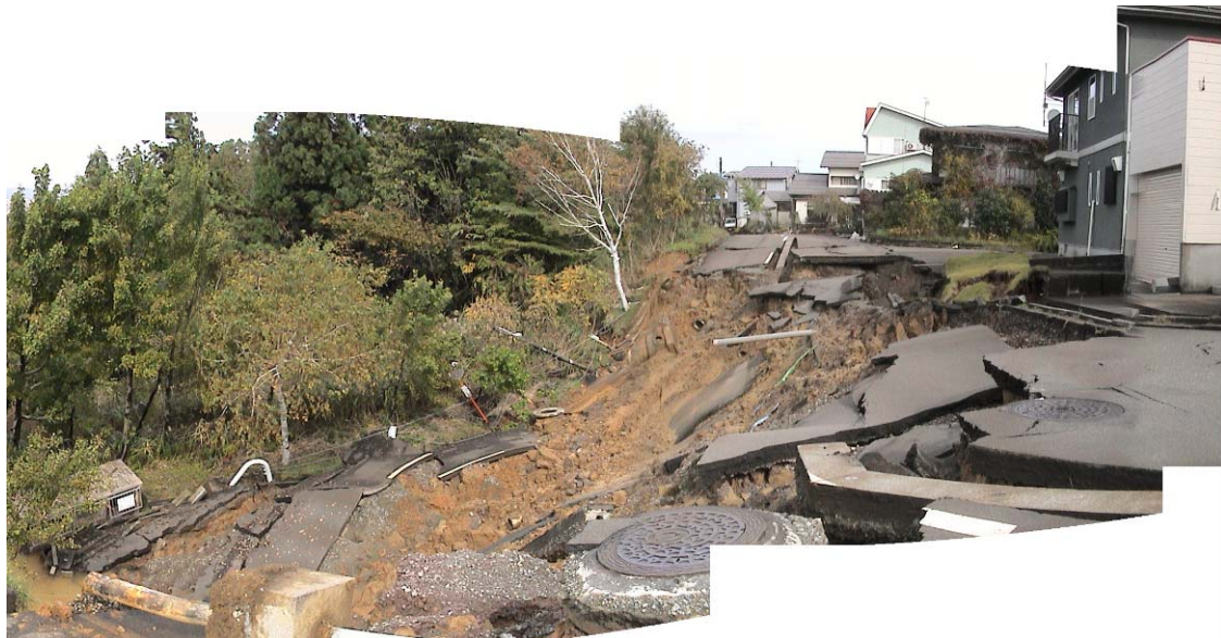
図参 1.1-⑦ 新潟県長岡市高町の盛土造成地の滑動崩落現象その1
