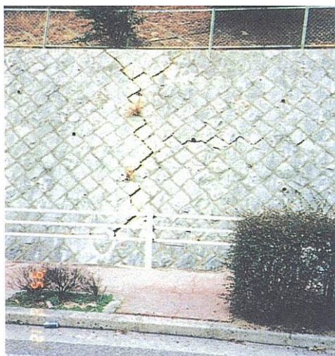
図VII. 3. 2 擁壁の沈下例 1
