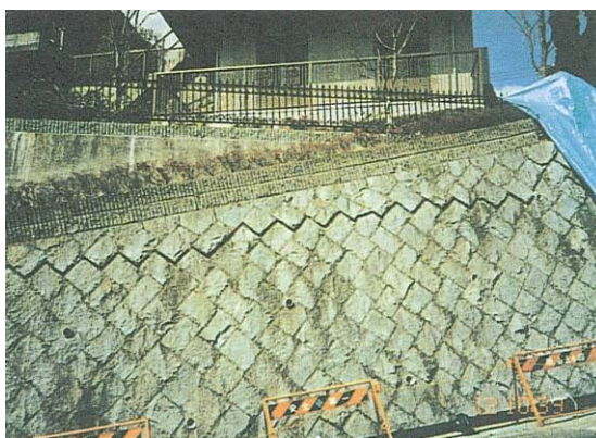
図VII. 3. 3 擁壁の沈下例 2
