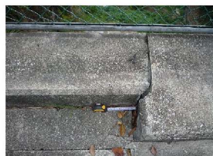
末端部の擁壁上部に見られる 擁壁のズレ
