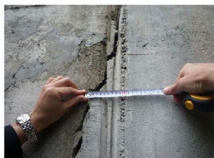
擁壁に見られるクラック (最大開口幅3cm)
