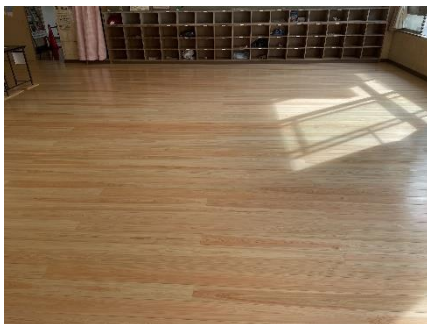
（市学童保育室への木質整備 床張替修繕（広谷学童保育室））
