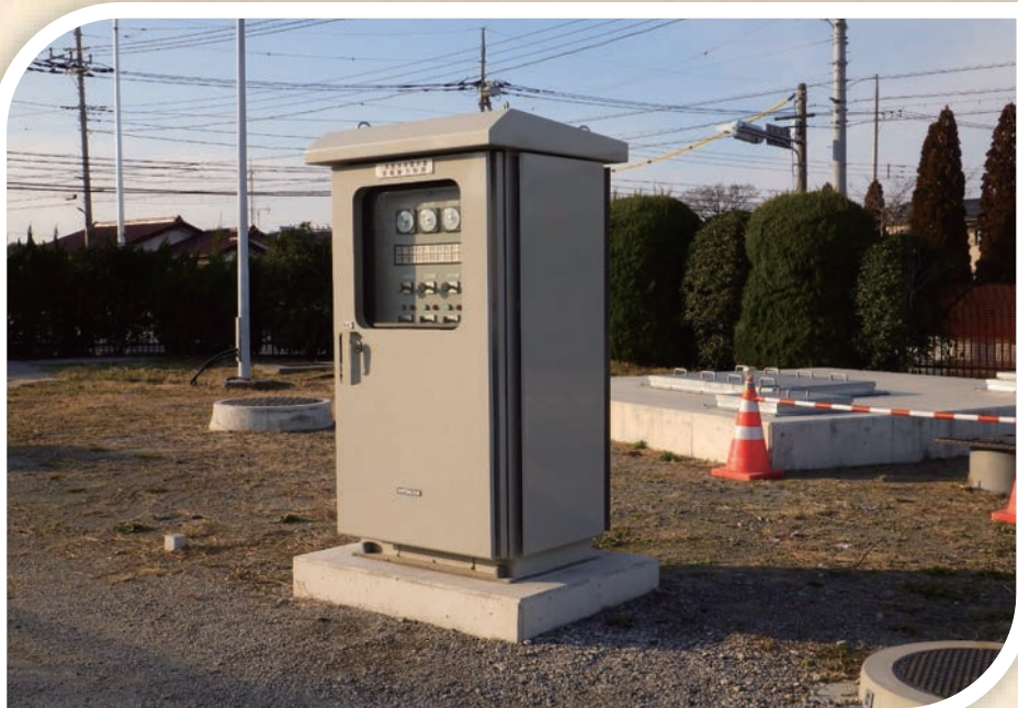
柿木浄水場1系配水本管弁室現場動力制御盤（草加市）
