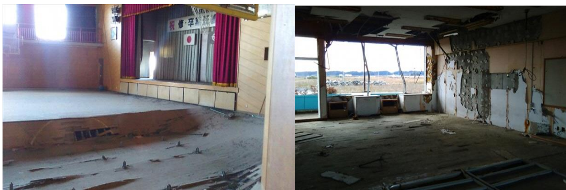
1階天井まで津波で浸水した浪江町立請戸小学校の内部（震災遺構として保存予定）
