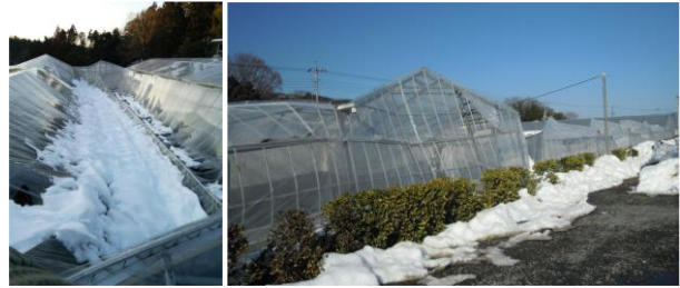
連棟ハウスの倒壊事例
