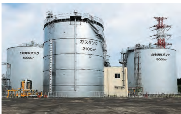
写真1-1 元荒川水循環センターに建設した消化槽
