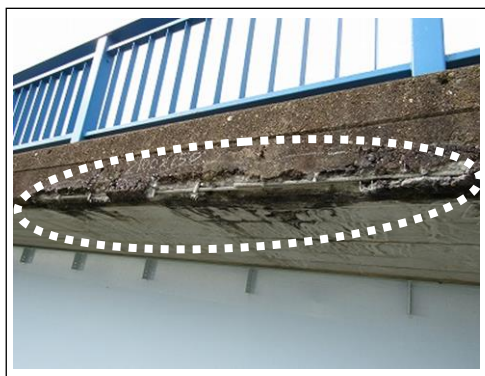
床版劣化事例
