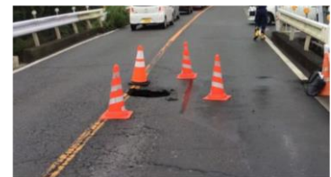
道路の陥没事例
