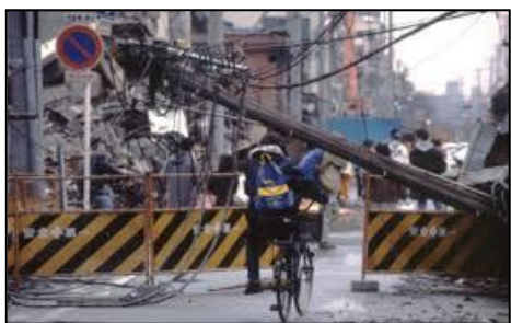
阪神淡路大震災での電柱倒壊
