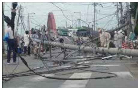
竜巻による電柱倒壊（越谷市）
