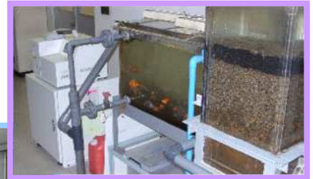
写真7：バイオセンサー と原水毒物監視水槽 （大久保浄水場）
