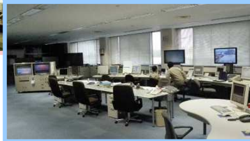
写真6：浄水場中央管理室 （行田浄水場）
