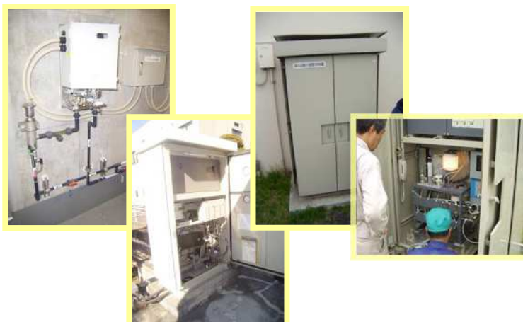
写真8：自動水質監視装置
