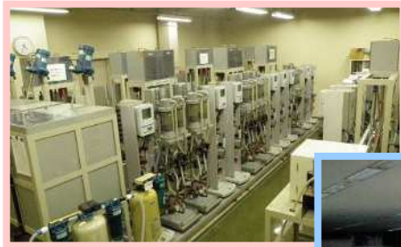
写真5：水質計器 （行田浄水場）
