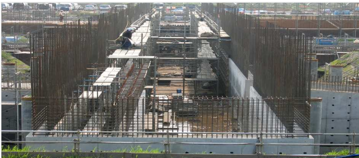
図 2-3 濃縮槽 東西共同溝(東側より撮影)
