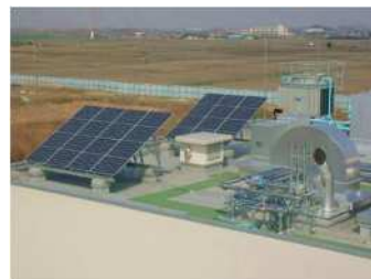
図2-41 太陽光発電システム
