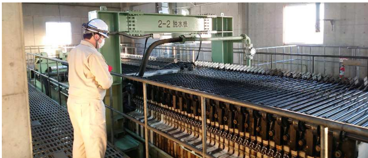
図 2-34 脱水機の運転・劣化状況の確認
