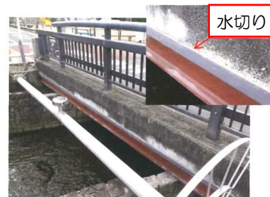
《地覆部側面の後付け水切り事例》 21
