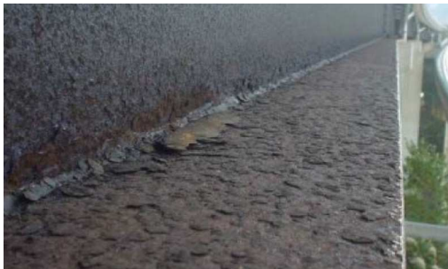
(i) 良好でない錆（うろこ状）
