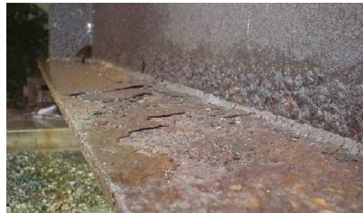
(ii) 良好でない錆（層状）
